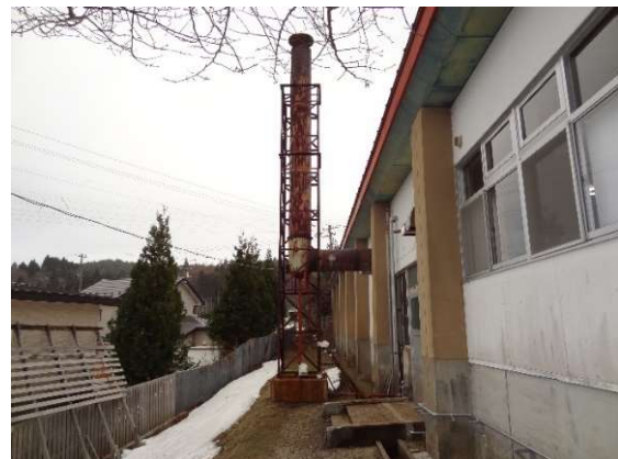
大畑学校給食センター（煙突錆び）
